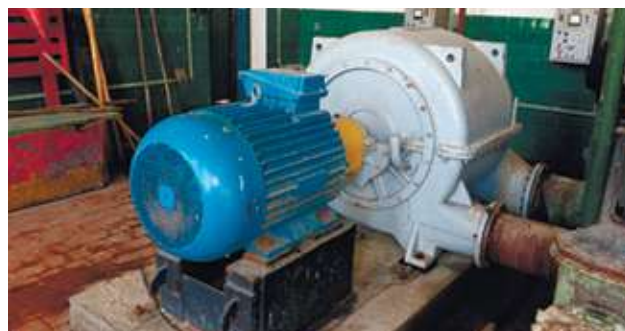
Рисунок 2 Воздуходувное оборудование, установленное 15 лет назад.
