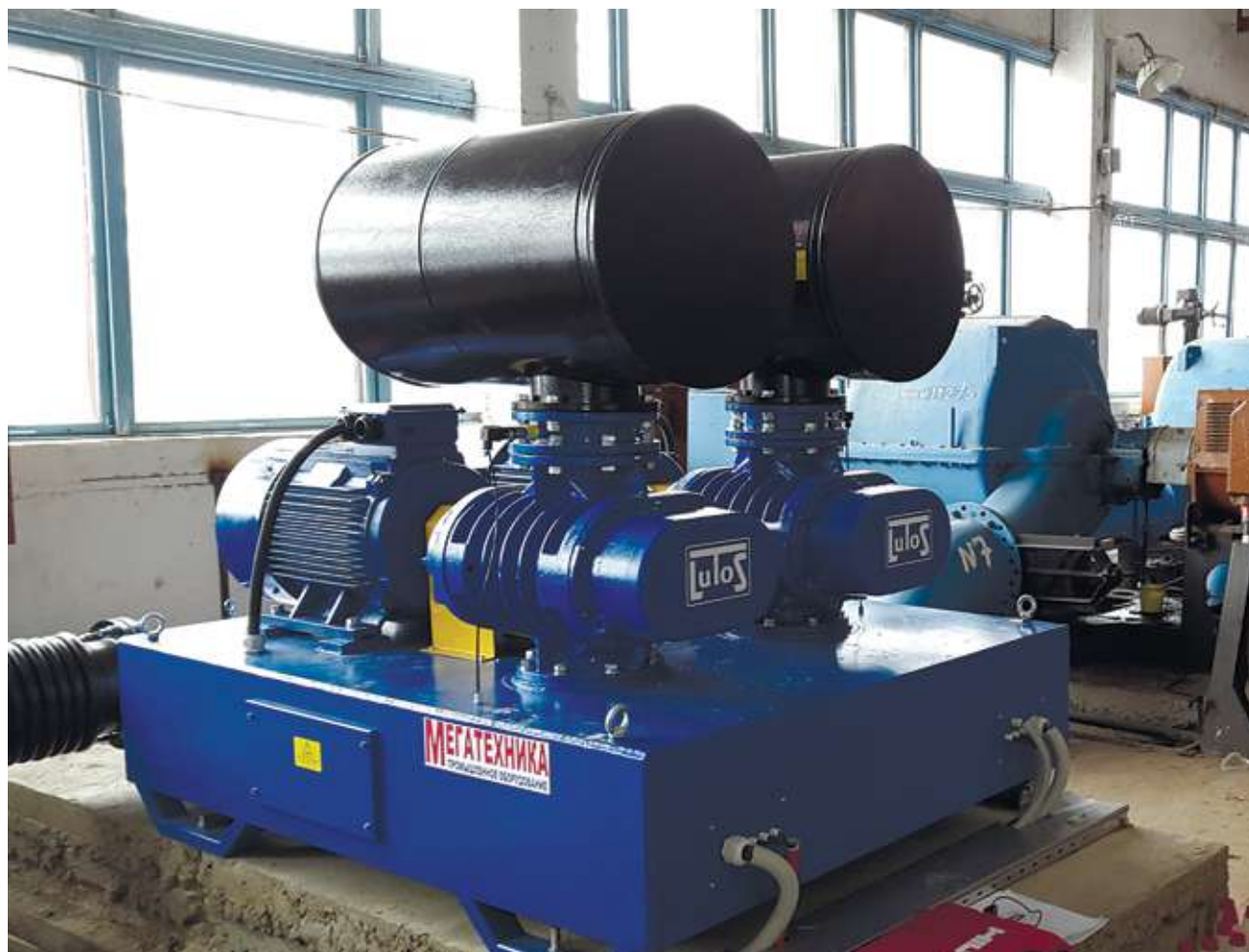
Рисунок 3 Воздуходувное оборудование, установленное компанией «МЕГАТЕХНИКА».
